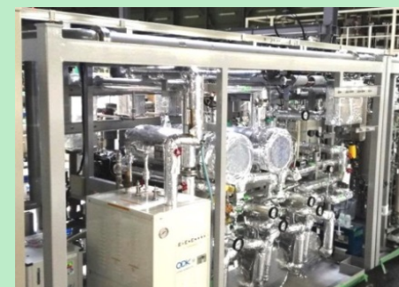
【NMP精製設備(実験装置)】
