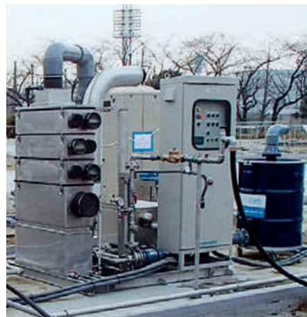
地下水浄化設備
